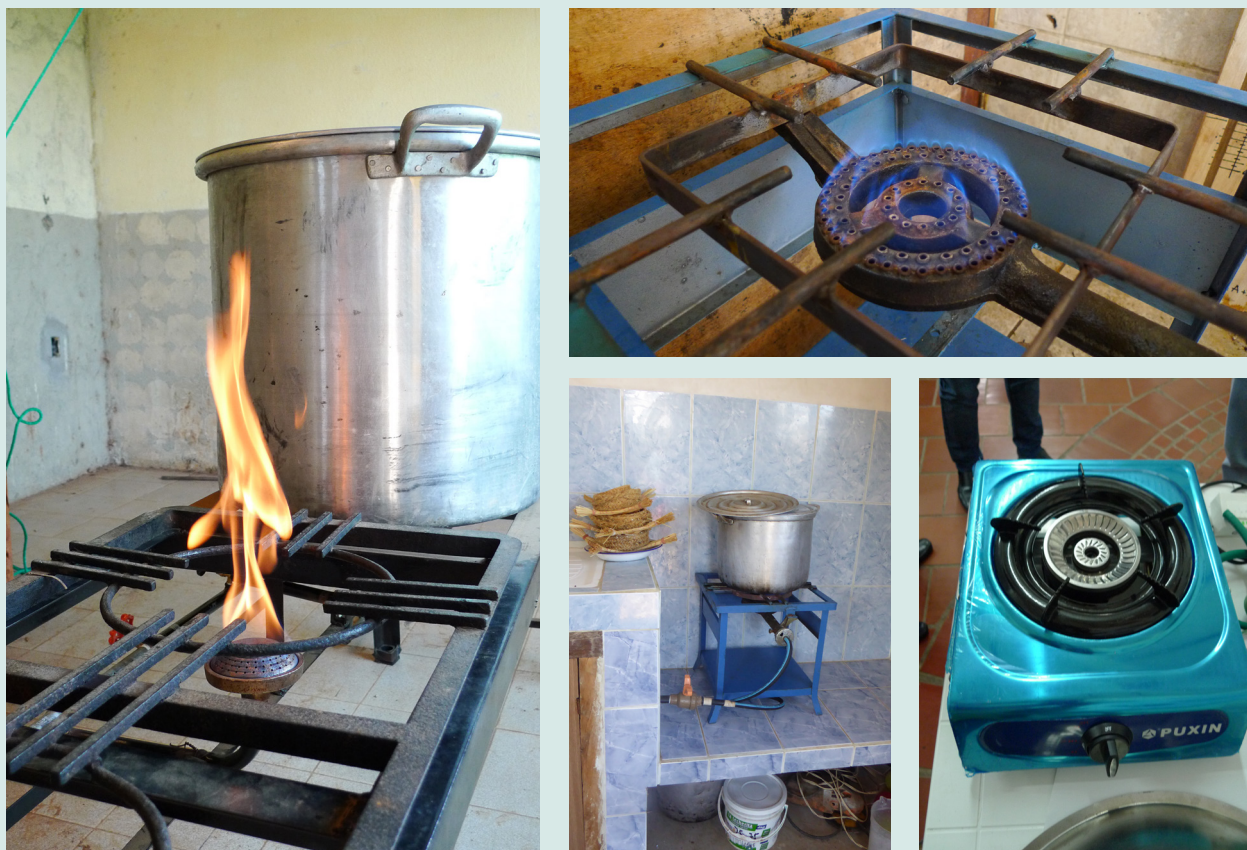
Figura 24: Diferentes tipos de cocina funcionando a biogás.
