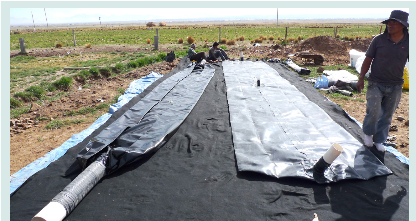
Biodigestor de plástico de invernadero negro humo a la izquierda, y biodigestor de geomembrana de polipropileno a la derecha (CIB3-UMSA, La Paz, Bolivia)
