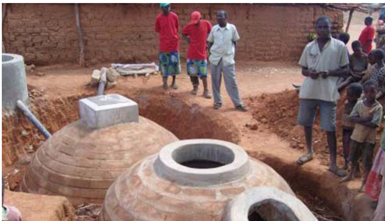
Imagen 1: Arriba- Diseño típico de un biodigestor de domo fijo con doble cámara, (Modelo CAMARTEC, Tanzania) . Abajo-biodigestor CAMARTEC construido, previo a ser tapado con tierra (CAMARTEC, Tanzania)
