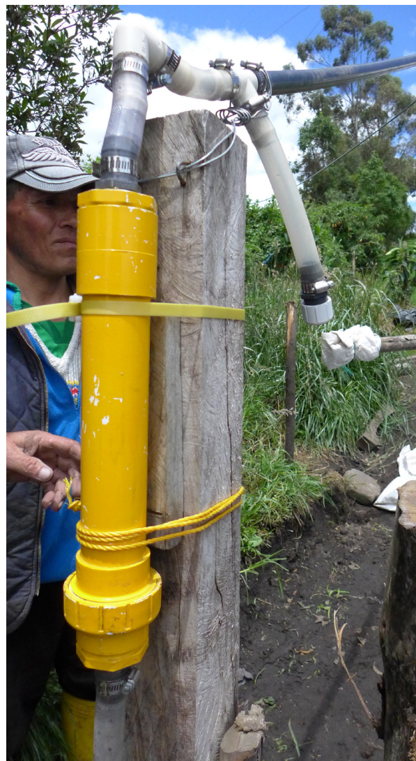
Figura 22: Arriba esquema y abajo foto de filtro de ácido sulfhídrico con purga de agua posterior
