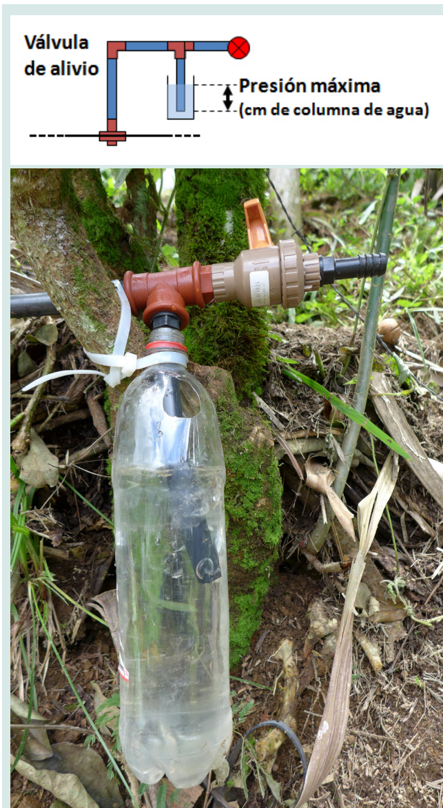
Figura 17: Arriba, esquema de la válvula de alivio. Abajo: fotografía de una válvula de alivio construida con una botella de refresco. En este caso la conducción de biogás acaba en la llave de la derecha, faltando su continuación hasta el lugar de consumo de biogás
