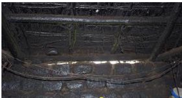
Figura N° 12: Interior de vivienda, paredes y cielo raso con hollín, comunidad talatag Fuente: Proyecto Vinculación PUCE 2023
