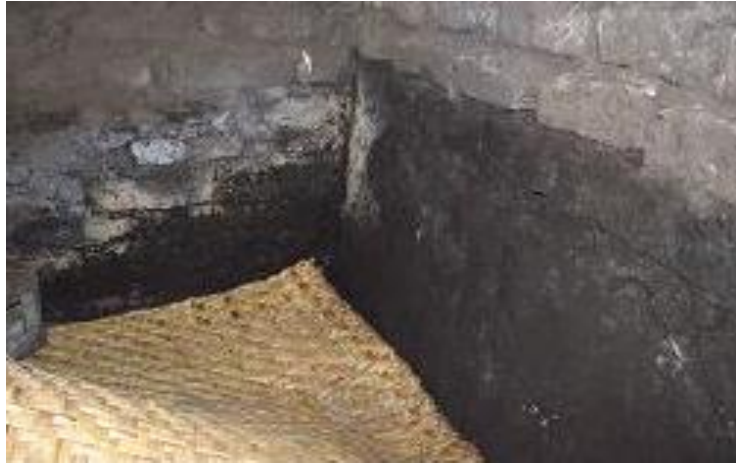
Figura N°10: Interior de vivienda de adobe, humedad en paredes comunidad Talatag
