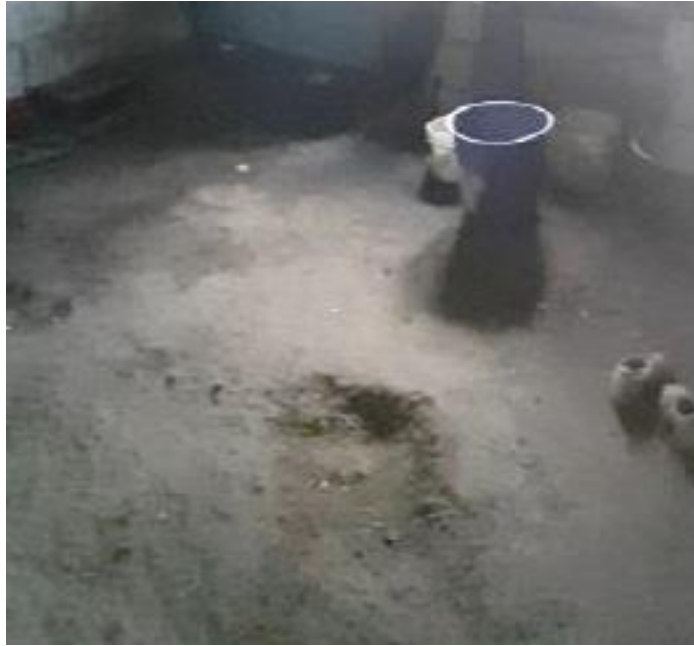
Figura N° 8: Piso de tierra en mal estado de conservación vivienda comunidad Talatag Fuente: Proyecto Vinculación PUCE 2023
