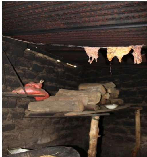
Figura N° 5: Interior Vivienda de adobe, hollín en paredes y cielo raso
