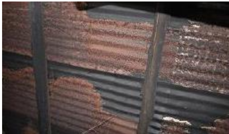
Figura N° 11: interior de vivienda, cubierta de Zinc, deteriorado por la presencia de humedad, comunidad Talatag
