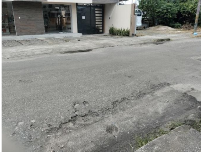
Figura 54. Desgaste en vía. Realizado por: Sabrina Vargas, 2023.
