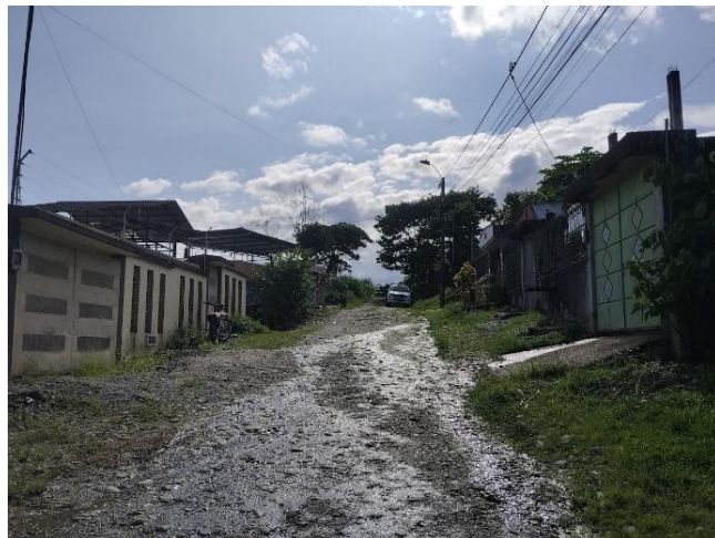
Figura 53. Calle secundaria lastrada en mal estado.
