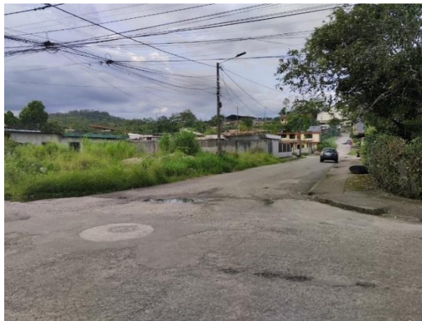
Figura 55. Desgaste en vía. Realizado por: Sabrina Vargas, 2023.
